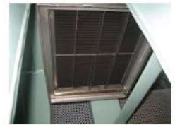
装置底部 (PAR入口吸気口)
