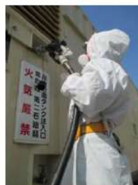
可搬型代替電源車の給油口への 接続 (クイックカップラ式) (可搬型代替電源車) (屋外)
