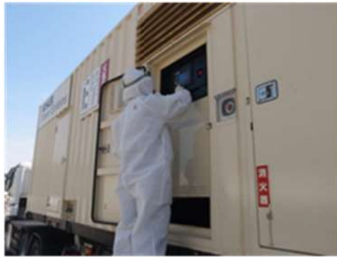
可搬型代替電源車起動 (屋外)
