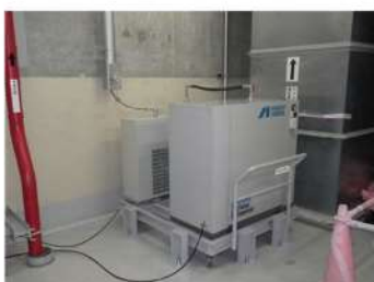
監視カメラ空冷装置
