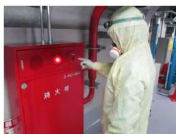
消火ポンプ起動 (燃料取扱棟 T.P. 33. 1m)
