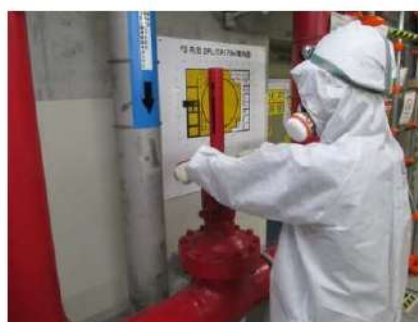
消火ポンプによる原子炉格納容器 下部への注水系統構成 （運転員（現場）C） （周辺補機棟 T. P. 17. 8m）
