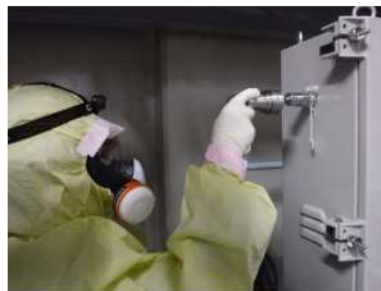
可搬型アニュラス水素濃度計測ユニットの接続 (周辺補機棟 T. P. 24. 8m)
