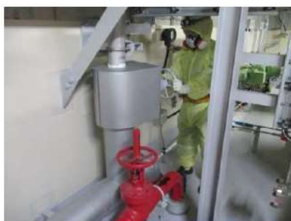
可搬型大型送水ポンプ車による原子炉格納容器下部への注水系統構成 （運転員（現場）B） （原子炉補助建屋 T. P. 10. 3m）
