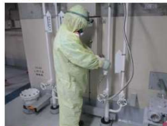
窒素供給操作(系統側バルブ操作) (周辺補機棟 T.P. 40.3m)
