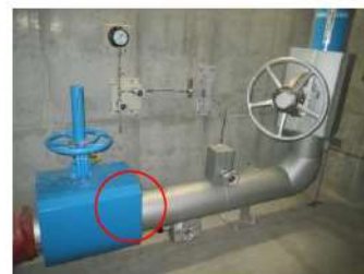
可搬型温度計測装置（格納容器再循環ユニット入口温度／出口温度）設置場所（排水側） (周辺補機棟 T. P. 17.8m)
