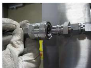
原子炉補機冷却水サージタンク 窒素供給ホースカップラ接続 (周辺補機棟 T. P. 43. 6m)
