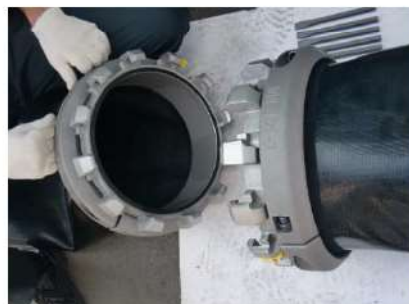
可搬型ホース(300A)接続
