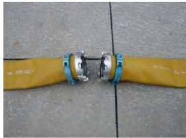
可搬型ホース（150A）接続前
