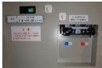
加圧器逃がし弁操作用バッテリー 繋ぎ込み (原子炉補助建屋 T. P. 10. 3m)
