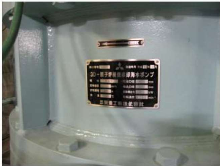
現場写真（原子炉補機冷却海水ポンプ）
