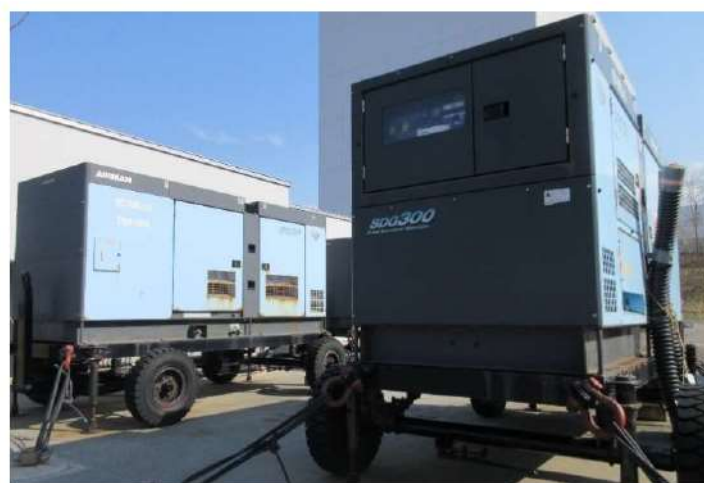
図4-11 緊急時対策所用発電機 外観
