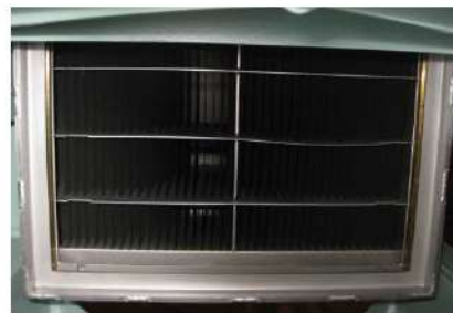
装置底部 (PAR 入口給気口)
