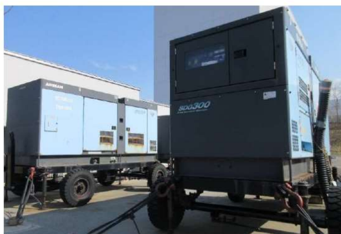
図4-11 緊急時対策所用発電機 外観
