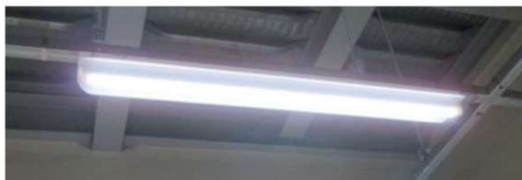
緊急時対策所照明（バッテリー内蔵 LED ランプ）
