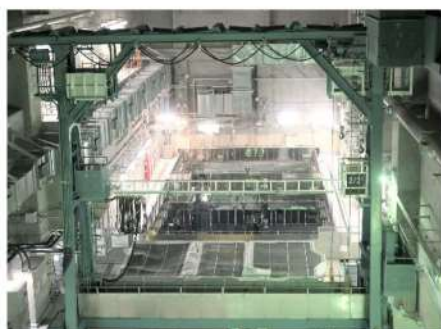
使用済燃料ピットクレーン
