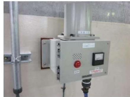
機器の固定状況
