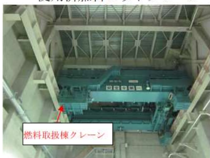
燃料取扱棟クレーン
