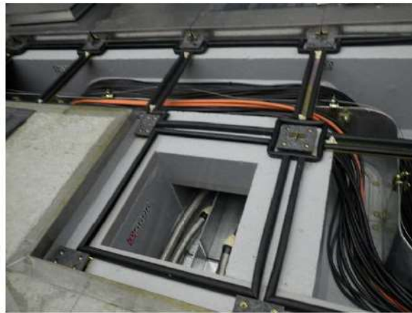
第 1-25 図：フロアケーブルダクトの状況
