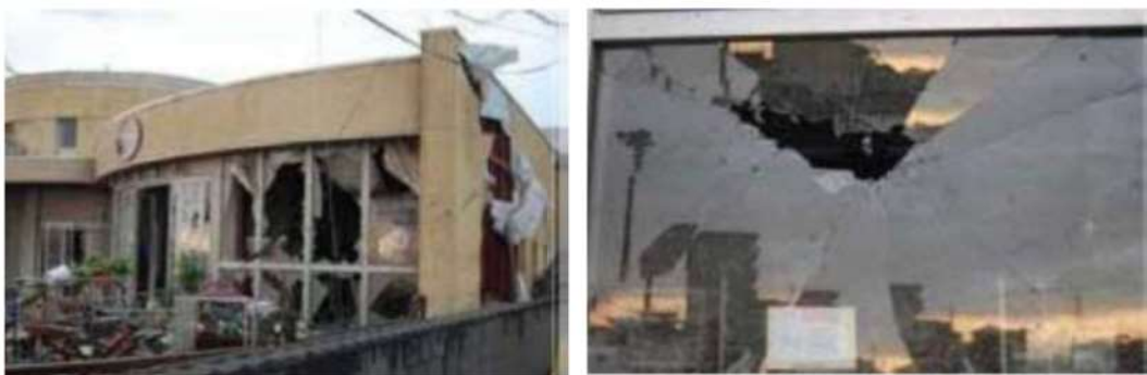
店舗の窓ガラスの被害状況
