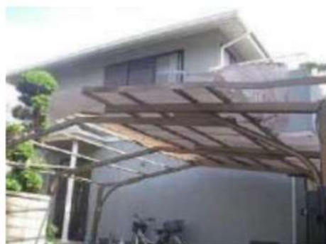
カーポートの被害
