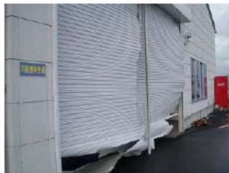
シャッターの破損
