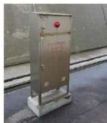
消火栓（ホース格納箱）
