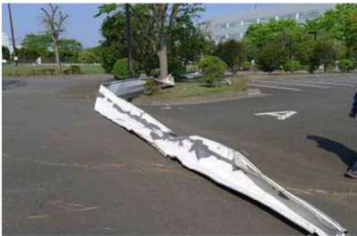
飛散した鋼板製屋根材
