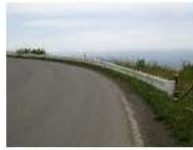
ガードレール
