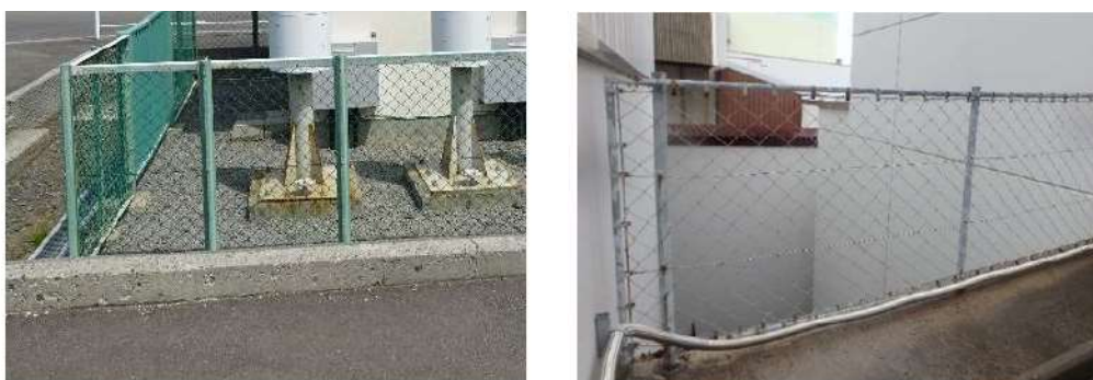
図33 泊発電所におけるフェンスの状況
