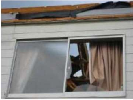
窓ガラスの損壊
