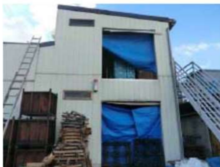
シャッターの被害
