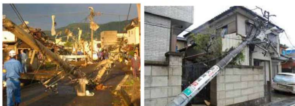
(電柱の折損, 傾斜)
