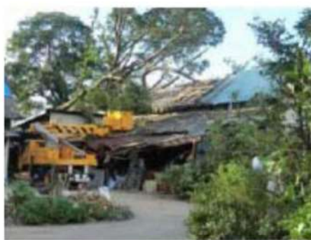
樹木の倒壊による小屋組の被害
