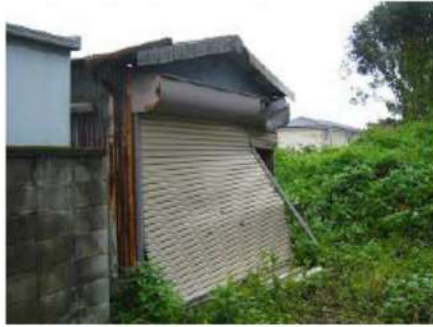
シャッターの外れ
