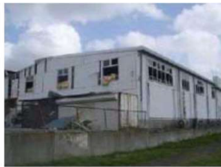
窓ガラスの破損
