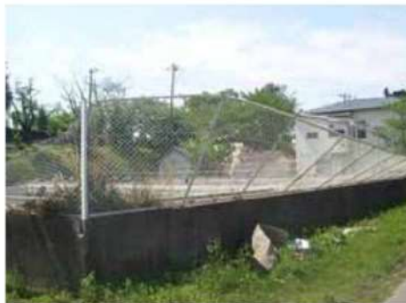
フェンスの被害状況
