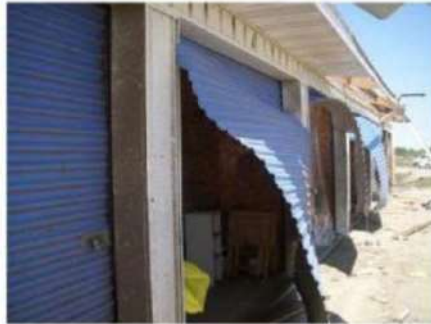
シャッターの被害
