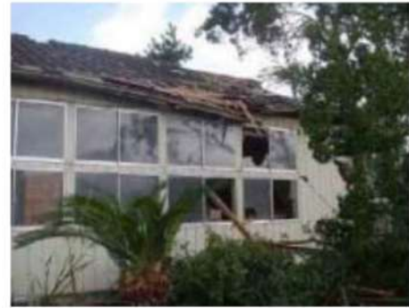
倉庫の窓ガラスと屋根の被害状況
