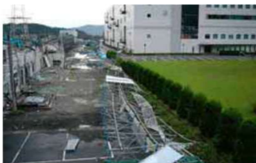
仮設足場の倒壊
