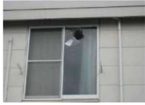
窓ガラスの飛来物衝突痕
