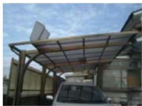
カーポート屋根の破損
