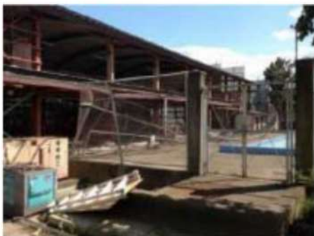
フェンスの被害（工事中の建築物）
