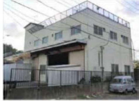
屋上フェンスの被害
