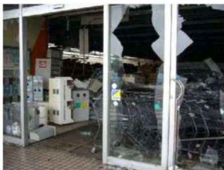
エントランスの窓ガラスの破損
