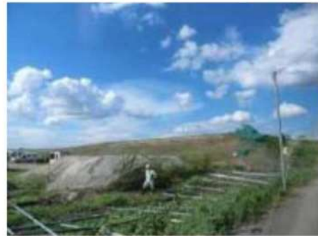
フェンスの被害
