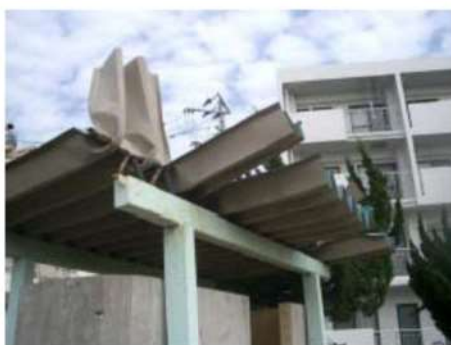
屋外トイレ屋根の損傷
