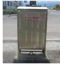
消火栓（ホース格納箱）
