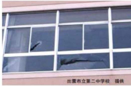
体育館窓ガラスの破損
