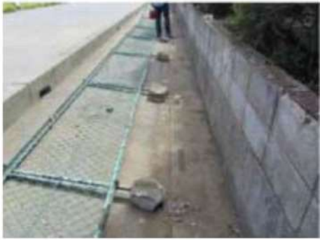
フェンスの倒壊
