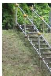
階段（単管パイプ製）
