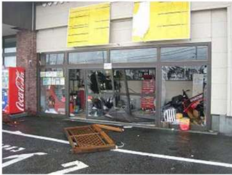
エントランスのガラス破損
