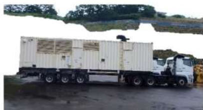
可搬型代替電源車
