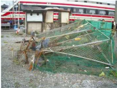
フェンスの著しい変形
