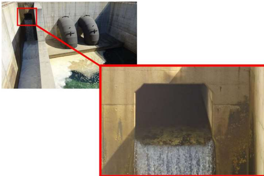
写真1 3号炉原子炉補機冷却海水放水路の海洋生物の付着状況
