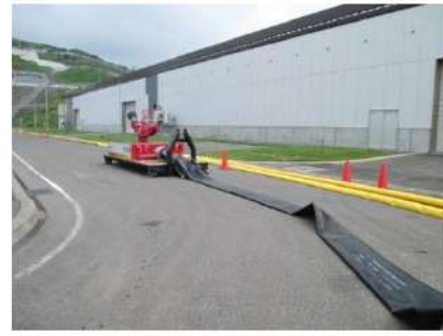
放水砲設置 (屋外)
