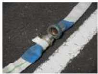
③ 可搬型ホース接続前
