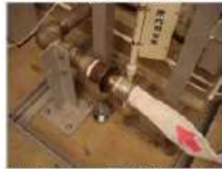
⑥ 可搬型ホース～使用済燃料ピット補給用 冷却配管 接続後
