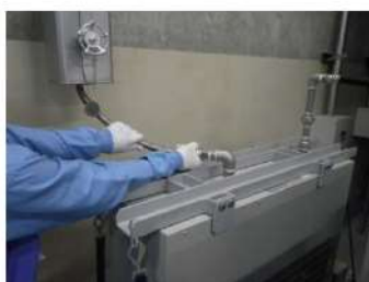
空冷配管との接続
