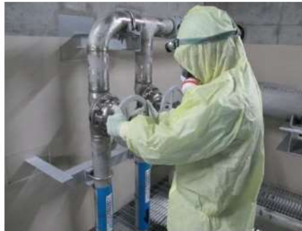
燃料取替用水ポンプによる注水系統構成 (周辺補機棟 T.P. 10.3m (中間床))
