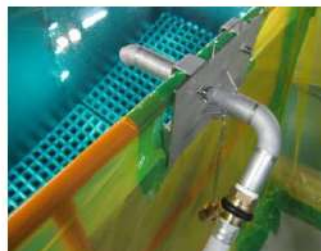
消防ホース接続 (燃料取扱棟 T.P. 33. 1m)
