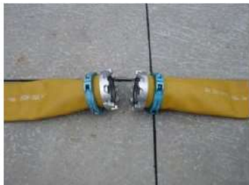
可搬型ホース（150A）接続前
