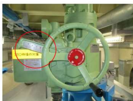
電動弁 (手動操作レバー) (周辺補機棟 T.P. 17.8m (中間床))
