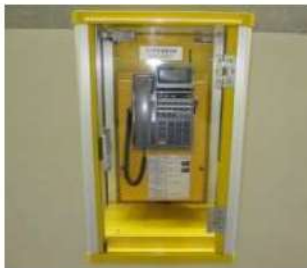
運転指令設備（警報装置を含む）
