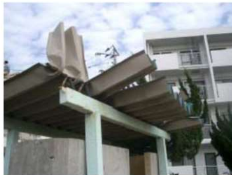
屋外トイレ屋根の損傷
