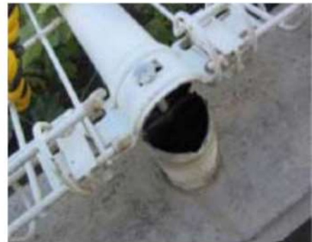
支柱部の破断
