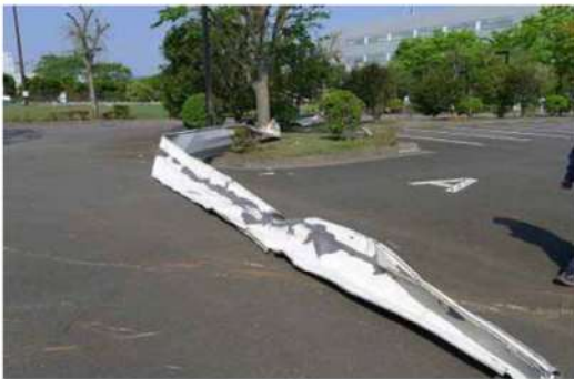
飛散した鋼板製屋根材
