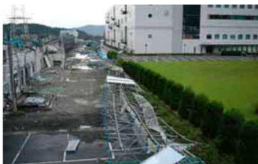
仮設足場の倒壊
