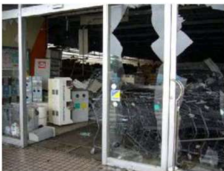
エントランスの窓ガラスの破損
