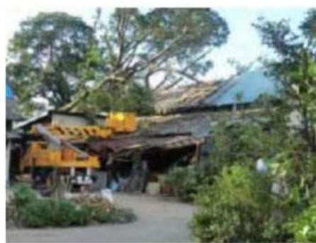
樹木の倒壊による小屋組の被害
