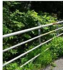
ガードパイプ
