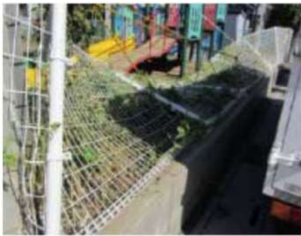
フェンスの倒壊
