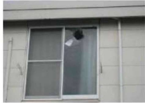
窓ガラスの飛来物衝突痕
