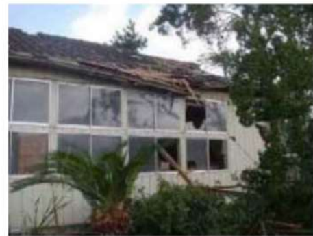
倉庫の窓ガラスと屋根の被害状況
