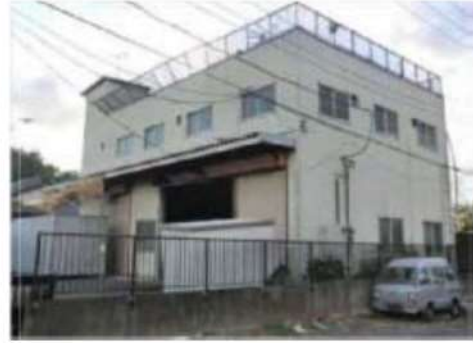
屋上フェンスの被害
