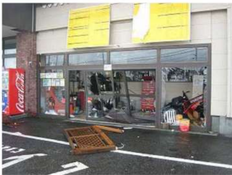
エントランスのガラス破損
