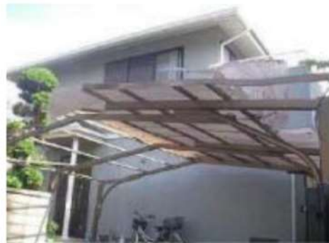
カーポートの被害
