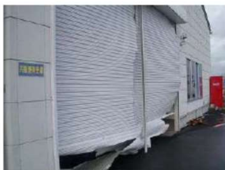
シャッターの破損
