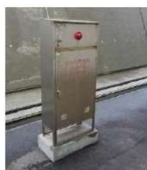
消火栓（ホース格納箱）
