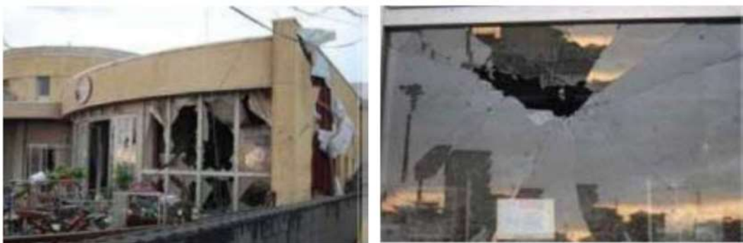
店舗の窓ガラスの被害状況
