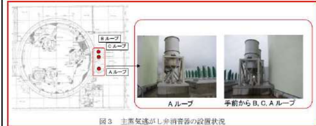
図3 主蒸気逃がし弁消音器の設置状況
