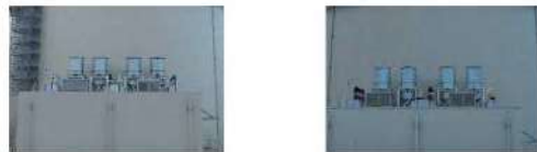
図3 主蒸気逃がし弁消音器の設置状況（左3号機、右4号機）
