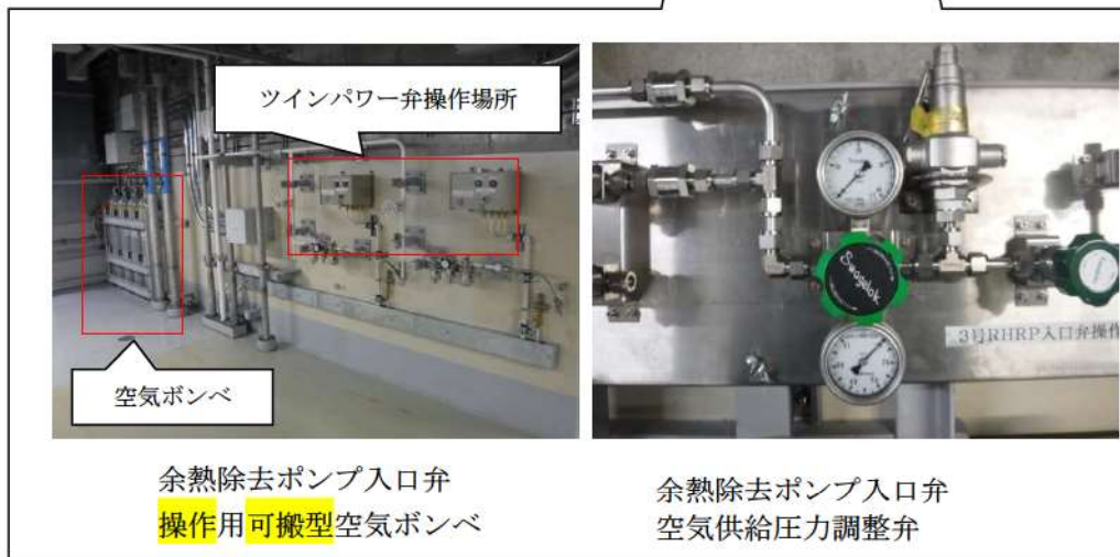
図3 ツインパワー弁操作場所及び余熱除去ポンプ入口弁操作用可搬型空気ボンベ
