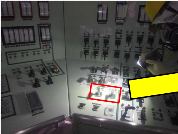
1号機中央制御操作室操作盤
