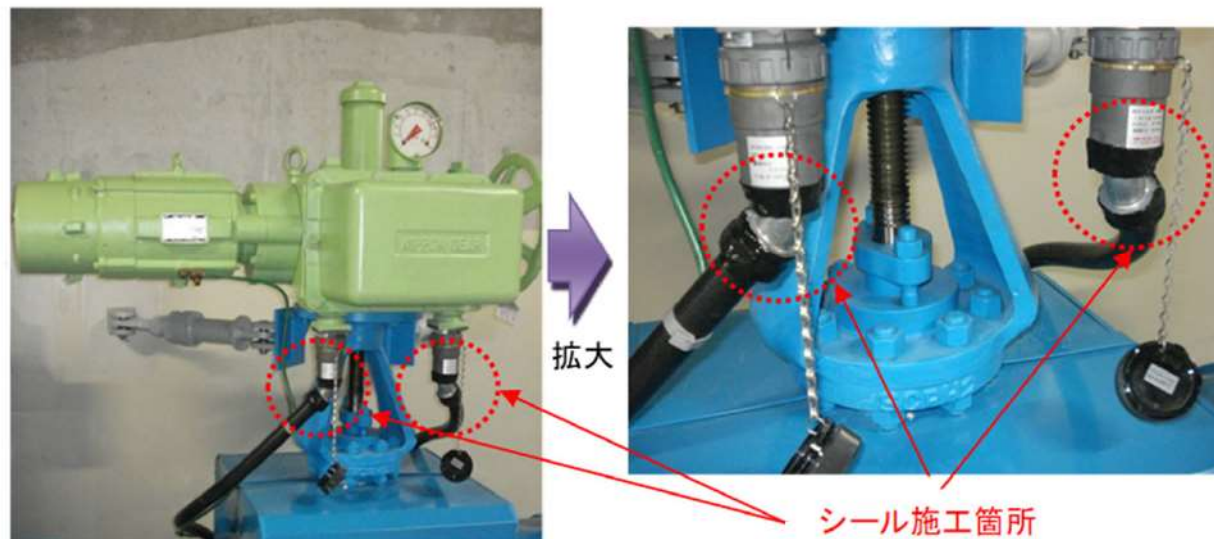
図5-6 被水対策状況
