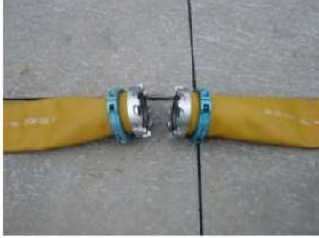
可搬型ホース（150A）接続前
