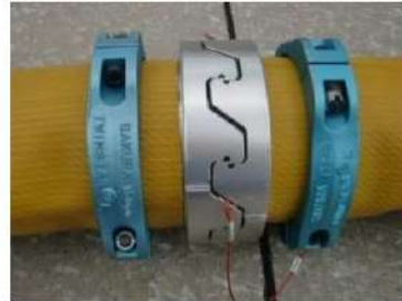
可搬型ホース（150A）接続後
