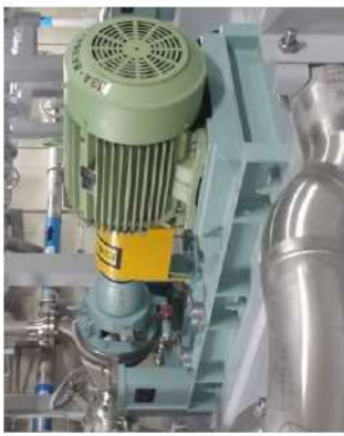
A-燃料取替用水ポンプ
