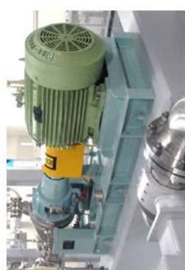
B-燃料取替用水ポンプ
