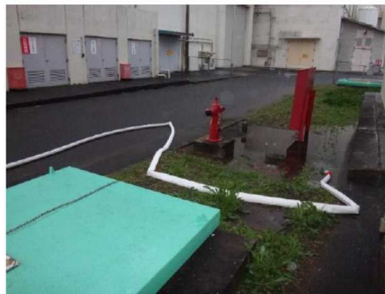
消火用ホース
