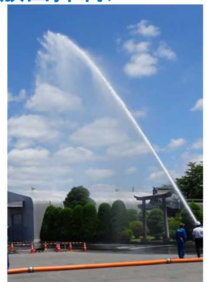
仮設放水設備
