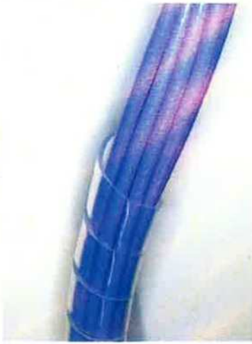
写真I-11 ケーブル終端側
