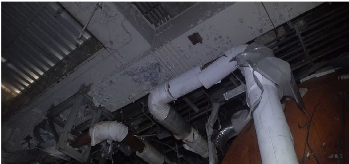
図 47 IC の南側付近の梁（1号機原子炉建屋4階） （IC（A系とB系の間）の上部）
