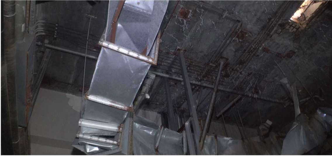
図 53 天井付近のダクト（1号機原子炉建屋4階）
