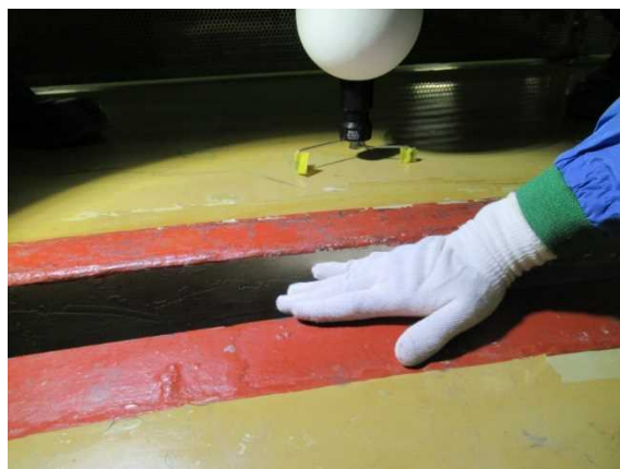
図 20 東端と DSP 側床面 (右図の左端) との間の状況 (敦賀 1 号機シールドプラグ) 10
