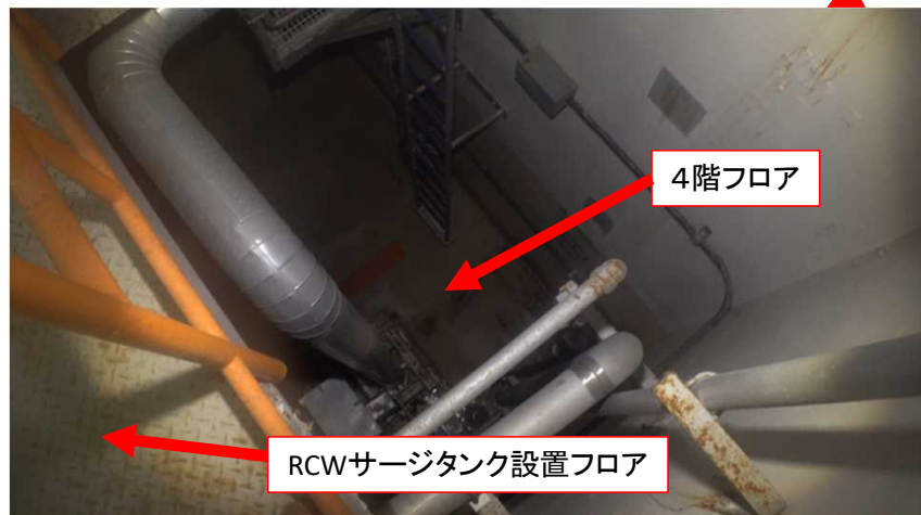
RCWサージタンク設置フロアから4階フロアを覗いた様子
