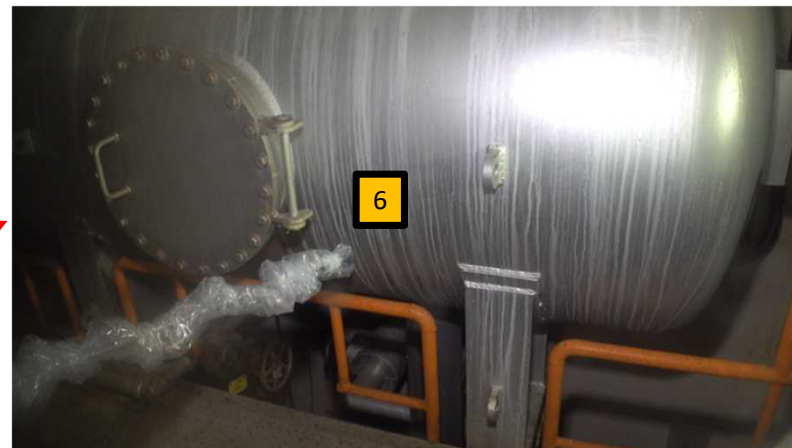
RCWサージタンク
