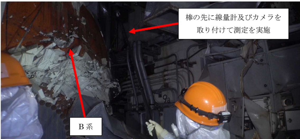
図 42 IC（B 系）の南側及び線量率測定の様子（1 号機原子炉建屋 4 階）
