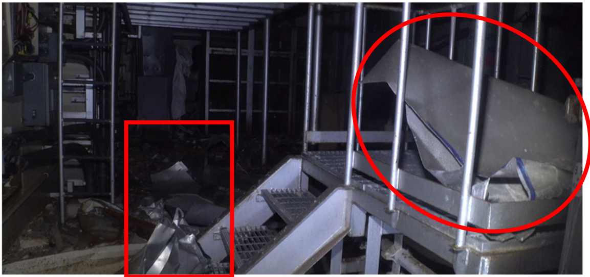
図 55 床面付近に落下したダクト（1号機原子炉建屋4階）
