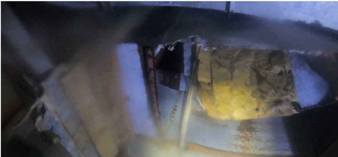
図7 1号機原子炉建屋3階東側の部屋（CRD リペア室）の状況 （めくれ上がったダクト）
