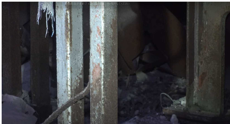
図8 MGセットの支持構造物の状況
