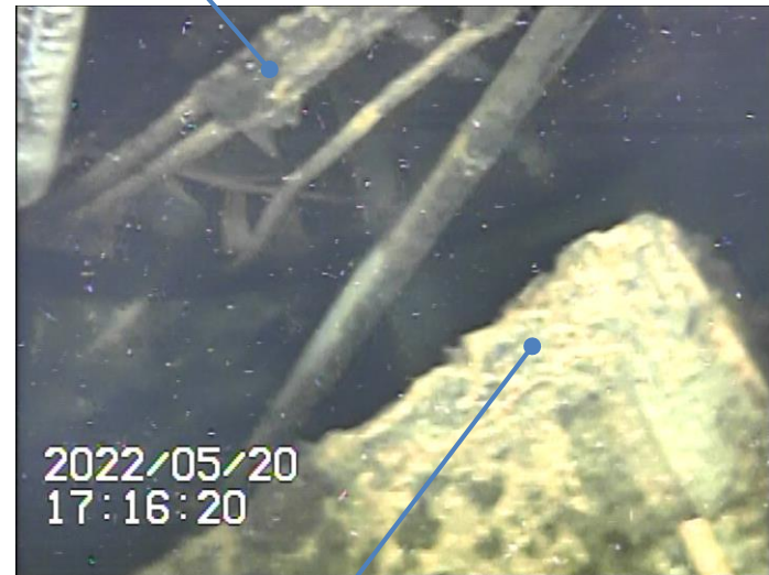
水中の構造物に付着した堆積物 (機器ドレンサンプの遮蔽体)
