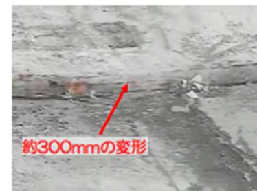
写真①シールドプラグの変形状況
