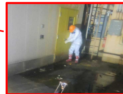
(燃料交換機遠隔操作室扉・開閉せず)
