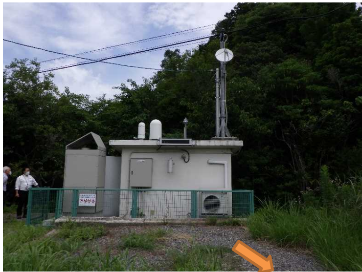
(外観) (発電所方向)
