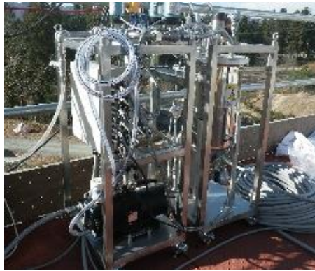
ポンプユニット
