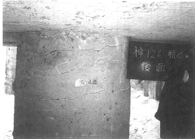
杭頭部の曲げひび割れ※1
