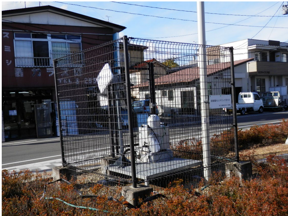
図2-10-11(3) 移設後の可搬型モニタリングポスト (須賀川市役所 (須賀川市) : 2021年11月8日撮影)
