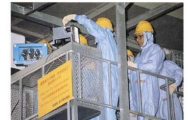
監視装置の保守管理
