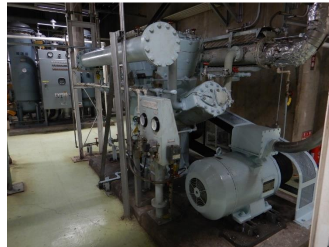
既設の空気圧縮機
