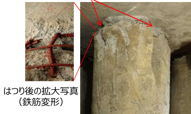
図28 No.8杭頭部の損傷状況
