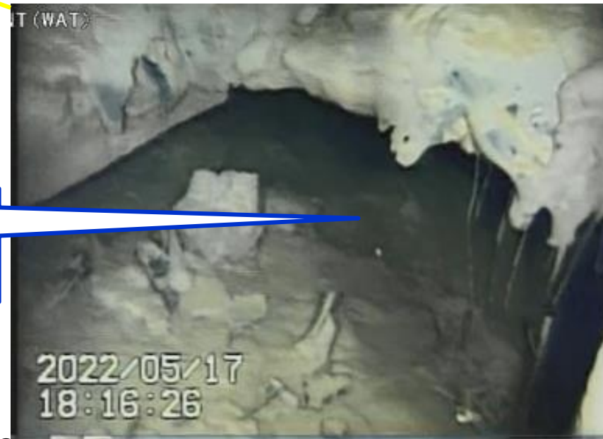
— 49 写真3.PCV底部の堆積物の状況(空洞内部)
