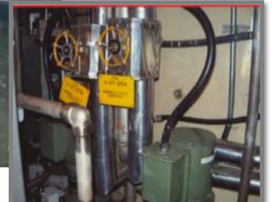
(参考写真)2011年事故前の状況
