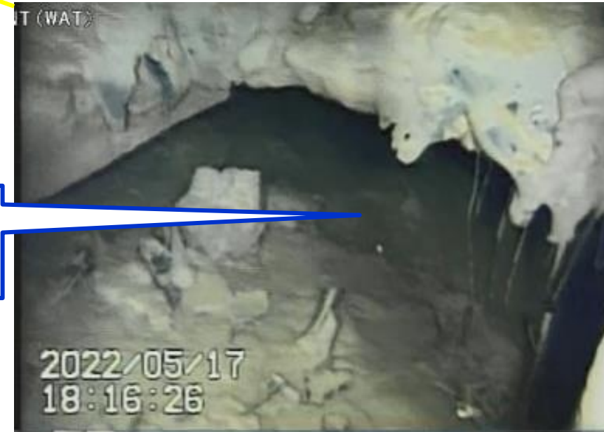
— 49 写真3.PCV底部の堆積物の状況(空洞内部)
