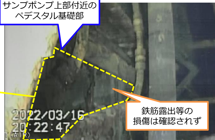
写真5. 遮へい板裏ペDESTAL壁面(堆積物上部)
