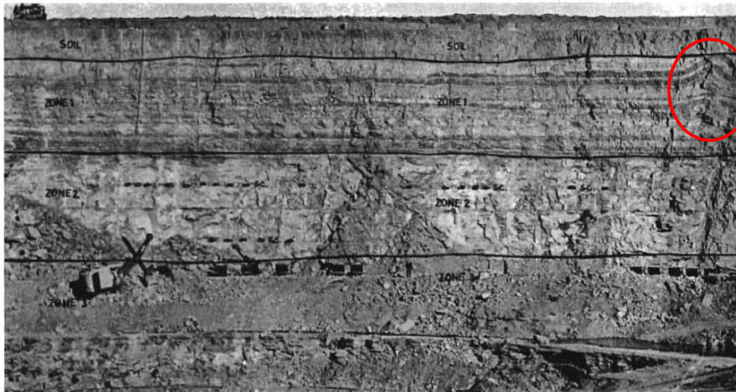
図1 採石場のピット西側壁。 右上(赤丸)の表層部の頁岩細互層中に膨張による小規模な褶曲有り。
