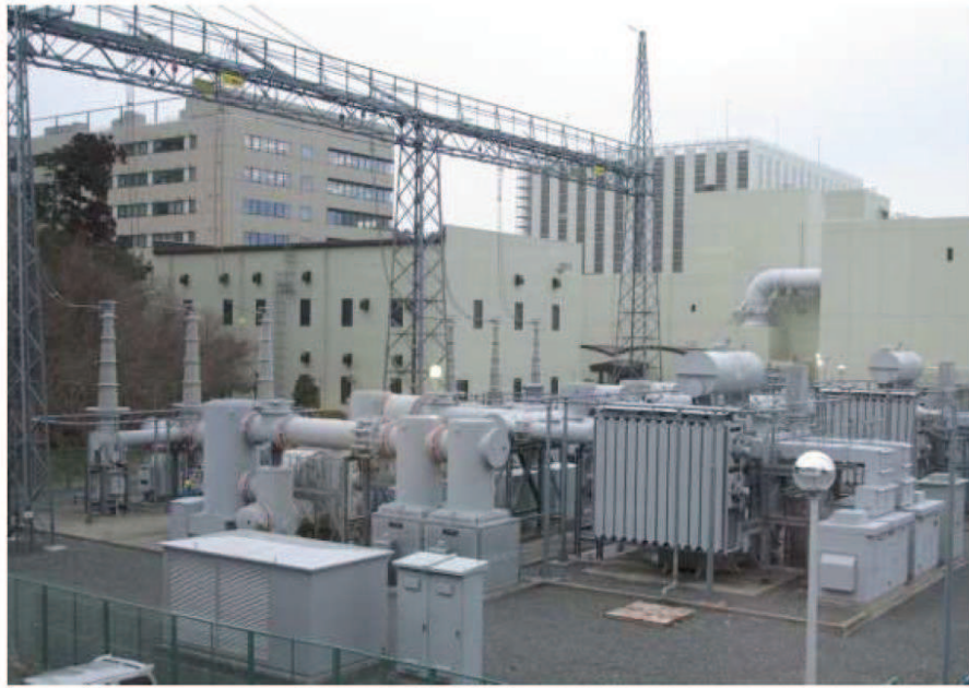
図 3-16 275kV 開閉所の外観
